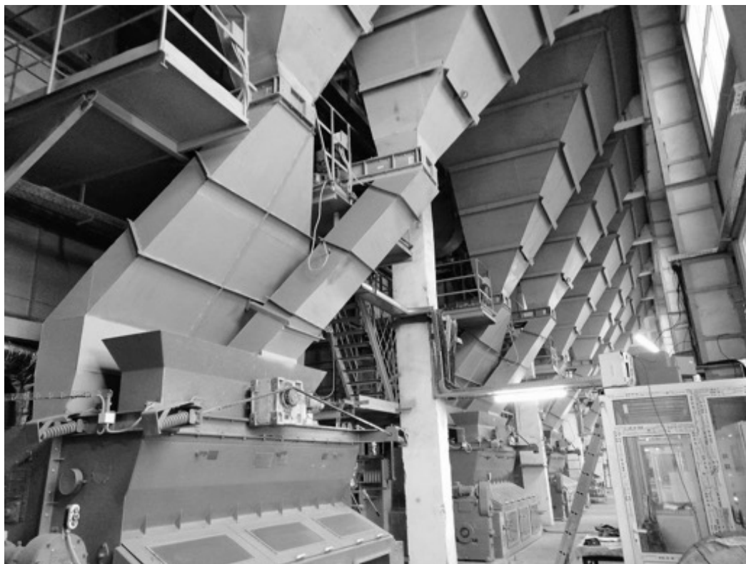
Рис. 5.5. Котли “Радіант” Хоростківського цукрового заводу, переобладнані на спалювання пелет з біомаси та/або газового вугілля
