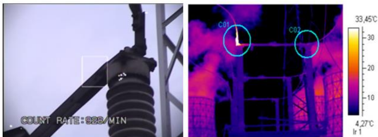
Рис.3.3 Коронний розряд в області оголовка при механічному ушкодженні опорного ізолятора роз'єднувача (а) і його термограма (б).
