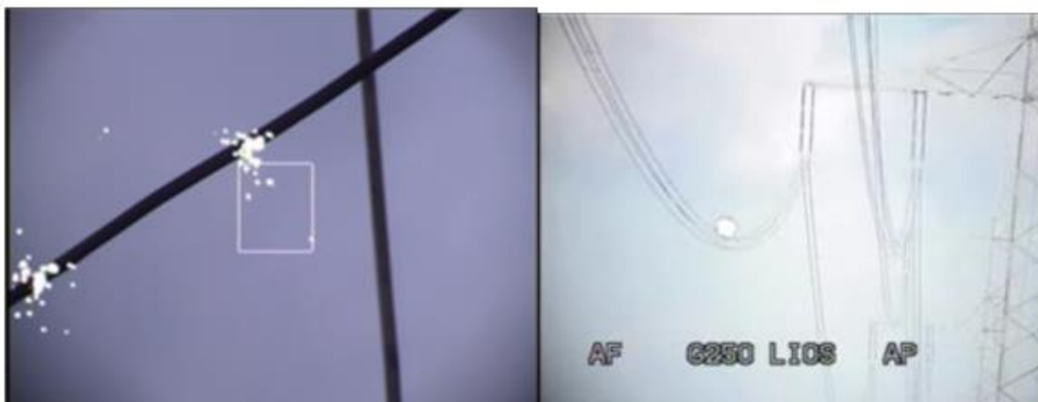
Рис.3.2 Коронний розряд на пошкодженнях елементів провідників ошиновки ВРУ (зліва) і високовольтної лінії (праворуч)
