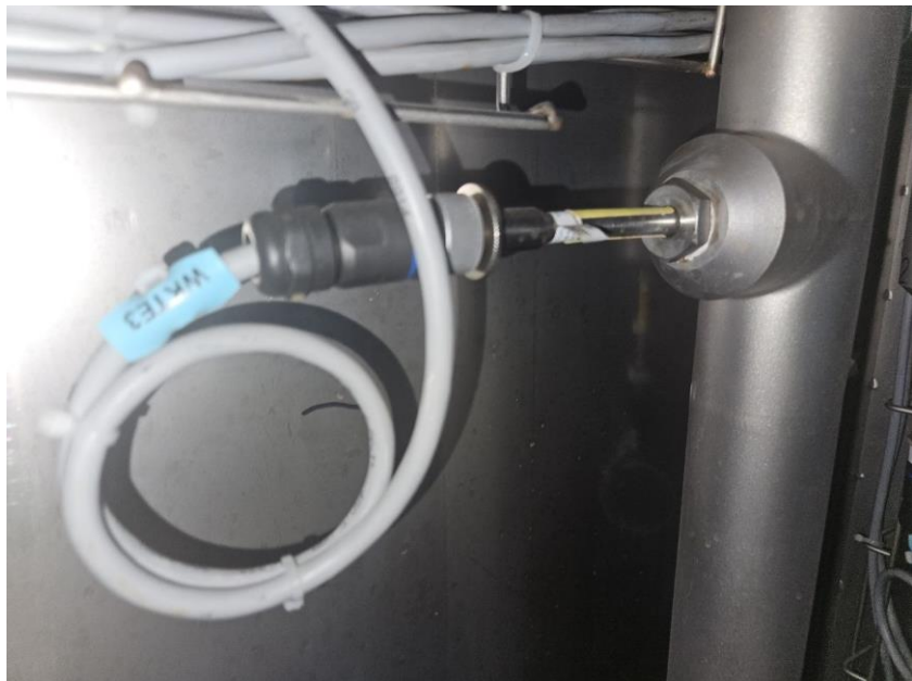
Рисунок 4.4 – Датчик ТСП ПТ100, який вмонтований в трубу.
