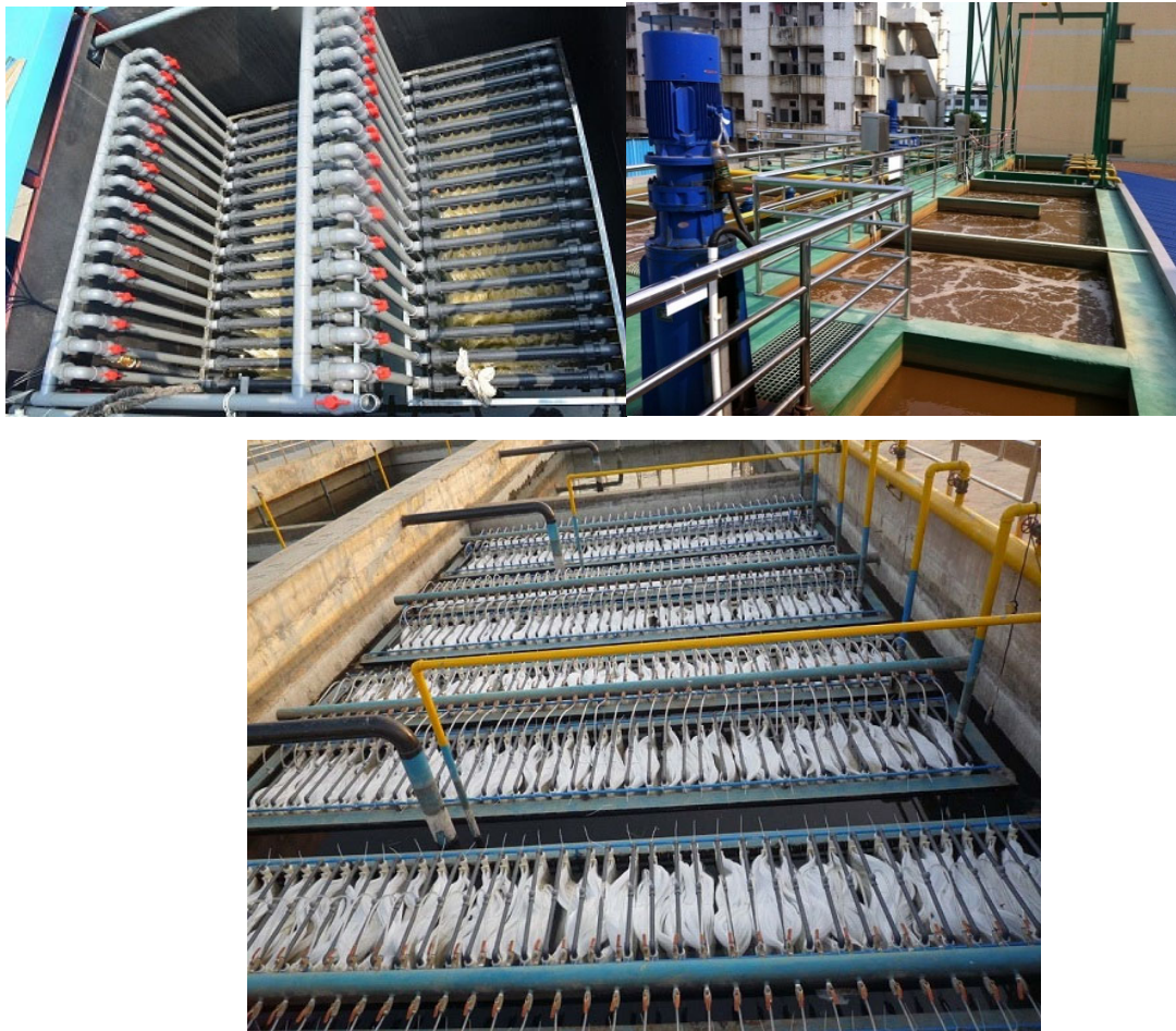
Рис.9.1. Реальна установка мембранного біореактора [79]
