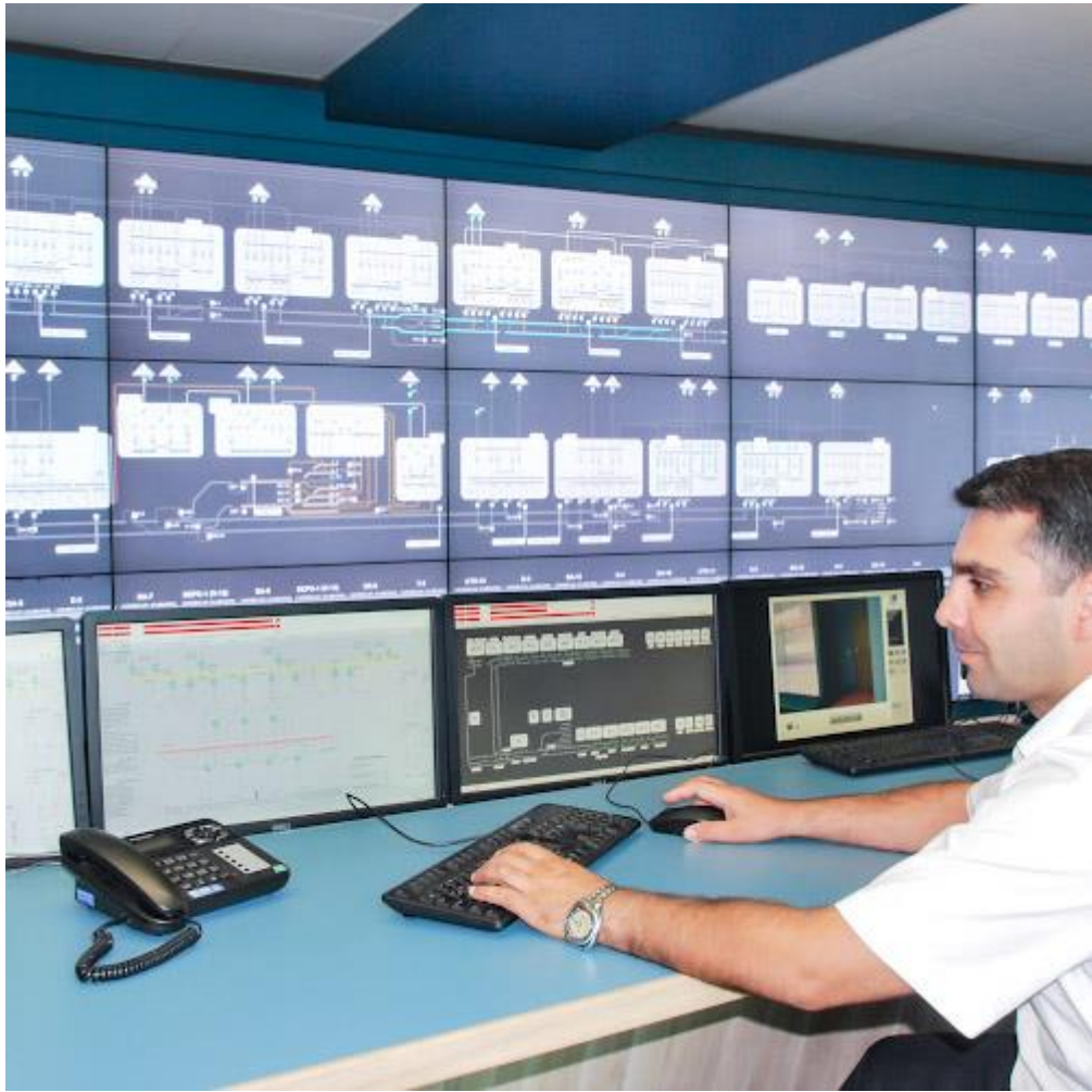
Рисунок 14.3. Автоматизоване робоче місце (АРМ) енергодиспетчера
