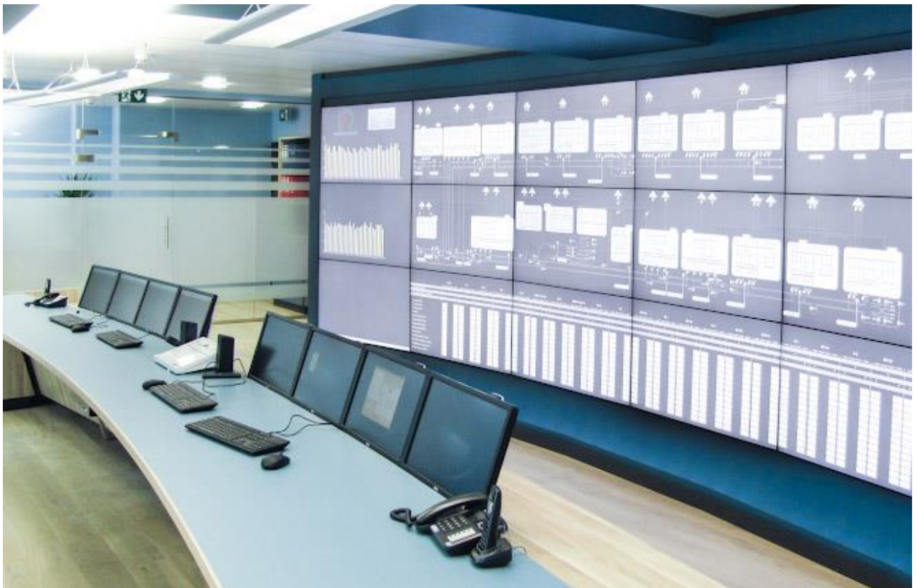
Рисунок 14.2. Обладнання енергодиспетчерського пункту управління
