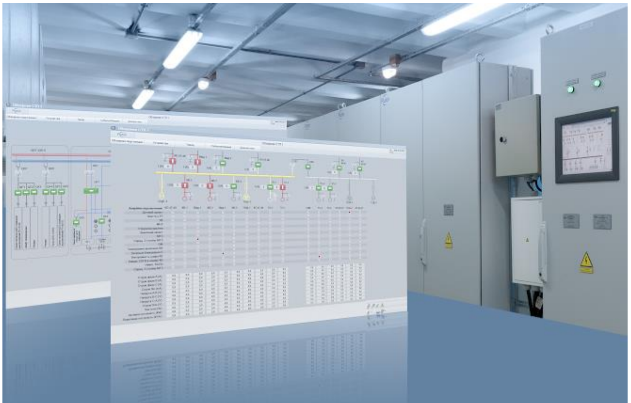
Рисунок 14.6. Контрольований пункт системи телемеханіки
