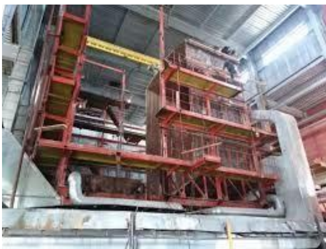
Рис. 1. Загальний вигляд водогрійного котла КВГМ-100
