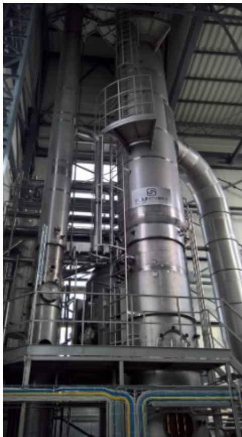
Рис. 4.2. Загальний вигляд вакуум-випарної установки.
