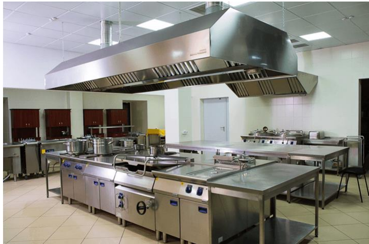
Рис.21 - Витяжка над плитами приготування їжі
