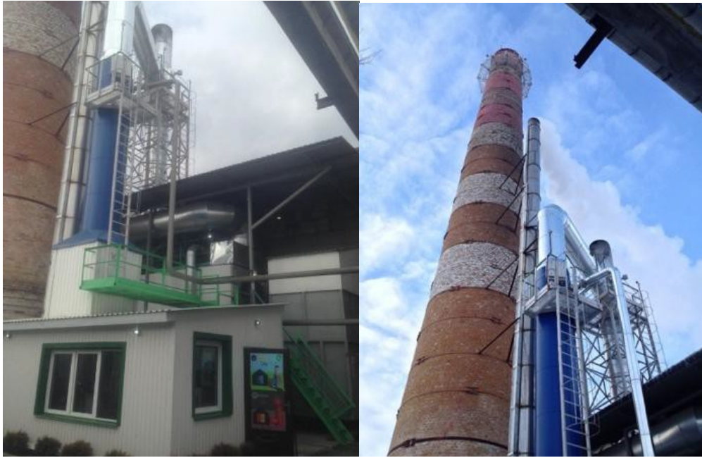
Рис. 2.1. Загальний вигляд біопаливної котельні аеропорту «Бориспіль» та економайзера Enerstena SEB 1000[18]
