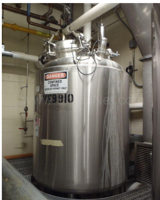
Рисунок 4.2 – Сталеві футеровані баки
