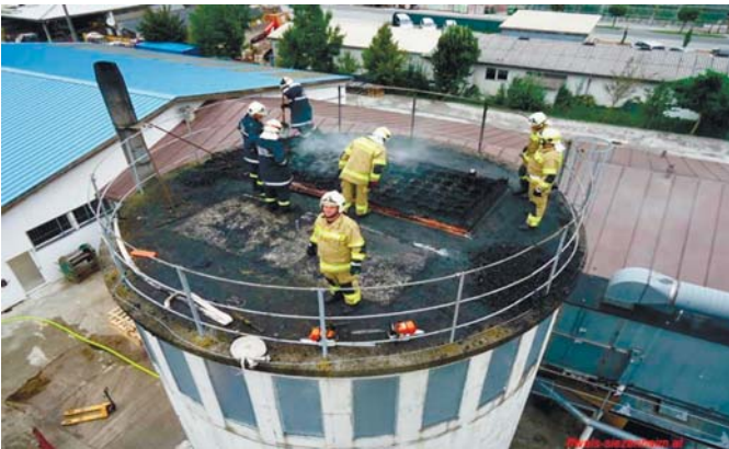
Рис. 5 – Стан силосної башти Wolf System після пожежі
