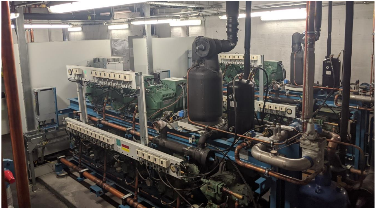
Рис. 24 Фото холодильної станції
