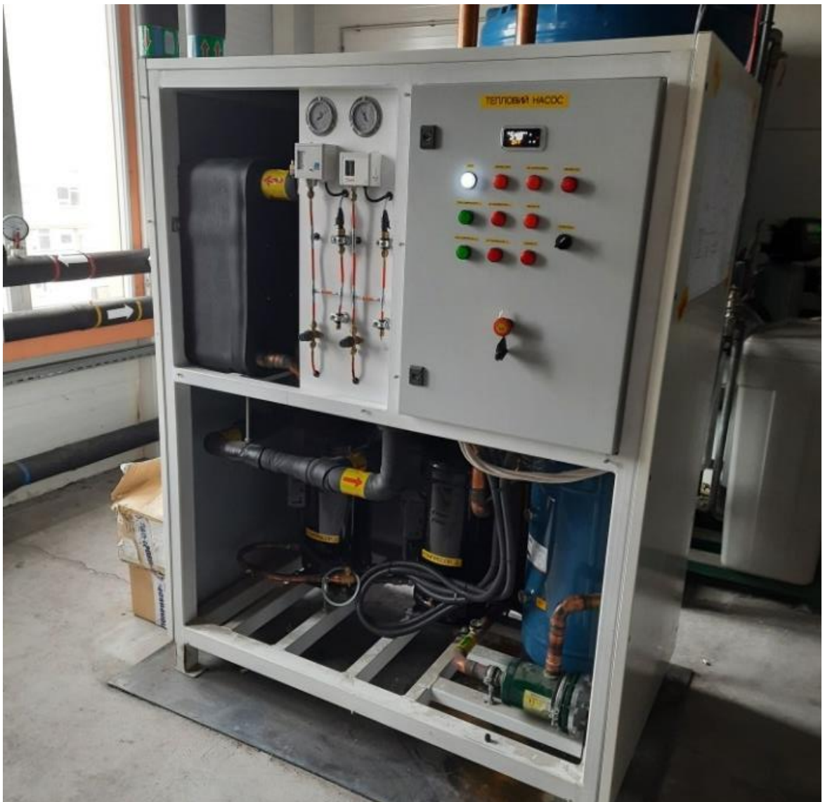
Рис. 23 Фото теплового насоса
