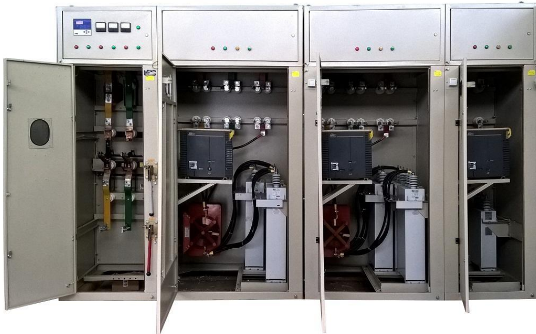
Рисунок 3.2 – Установка компенсации реактивной мощности УКРМ-10,5 -450- (3х150) УЗ
