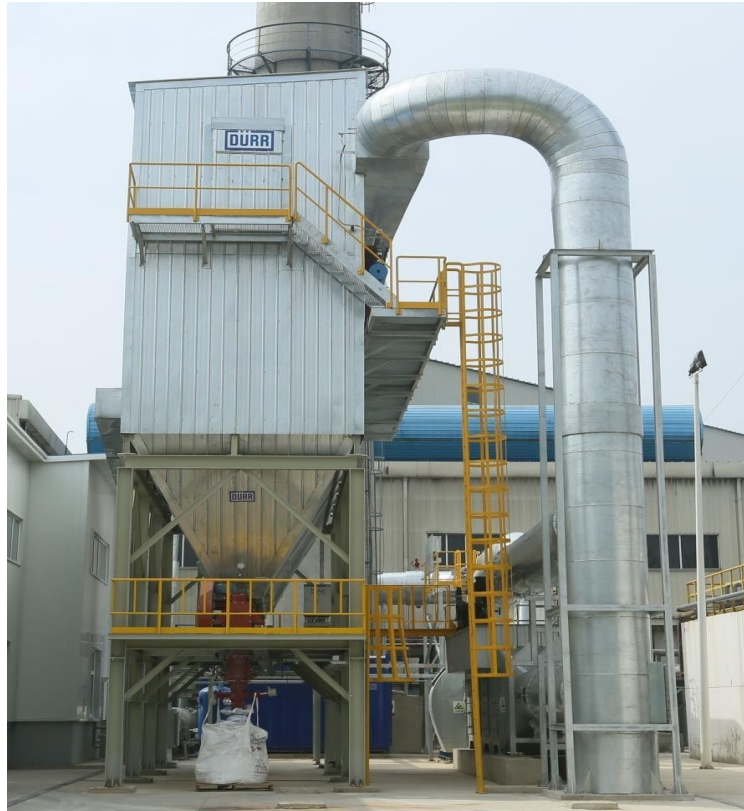
Рис.2.1. Каталітичні свічкові фільтрувальні елементи та загальний вид фільтра Dürr
