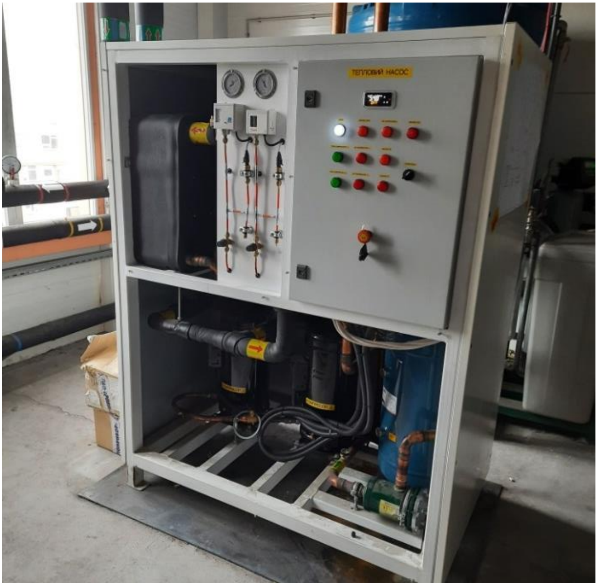
Рис. 18. Фото теплового насоса
