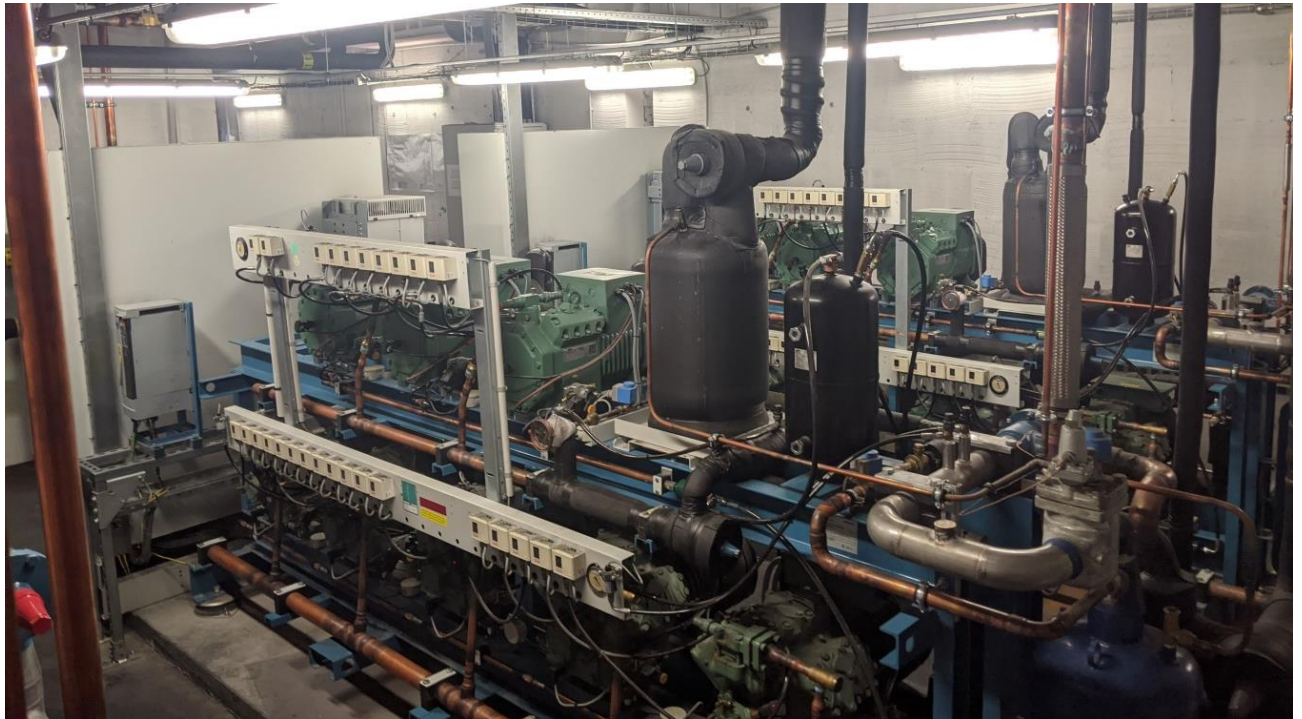
Рис. 19. Фото холодильної станції
