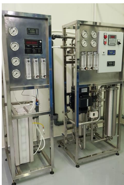
Рис. 2 Установка очищення води RO- EDI (мембрана - LC- HR 4040, марка модуля електродіонізації - Snow Pure EDI XL- 200)
