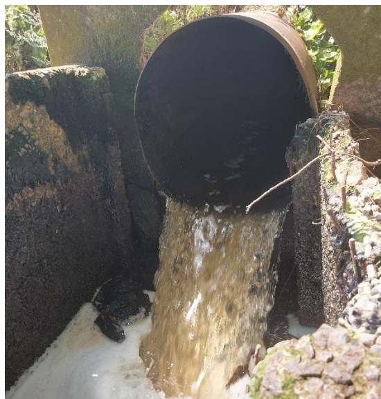
Рис.2. Труба скиду стічних вод КОС міста Біла Церква
