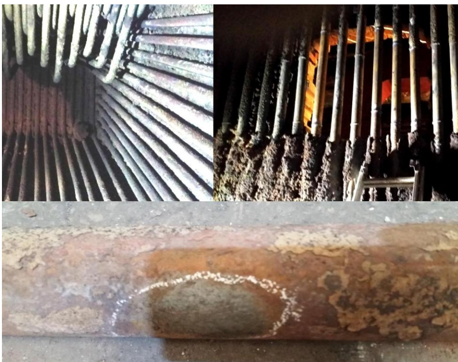
Рис. 1. Забруднена водотрубна частина екранних труб і фрагмент перегрітої екранної труби
