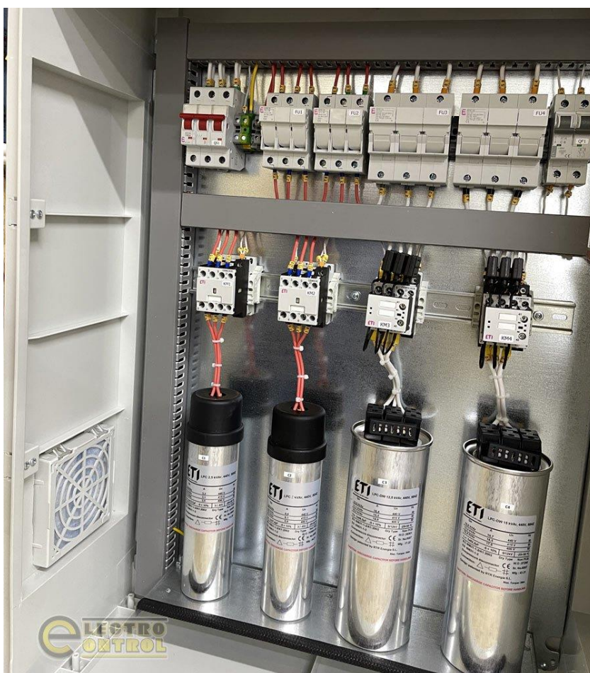
Рис. 3.1. Загальний вигляд конденсаторної установки УКРМ-0,4-50-10УЗ
