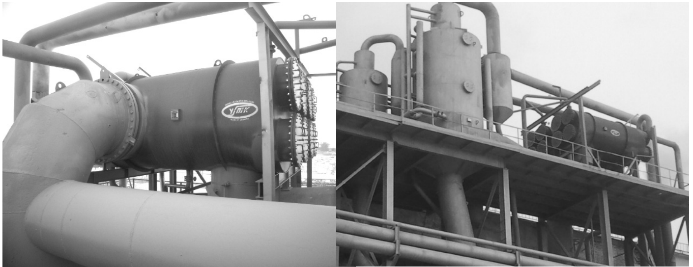
Рис. 3. Вид змонтованих підігрівників дифузійного соку ПДСУ-2000, що обігрівається вторинною парою вакуум-апаратів I кристалізації
